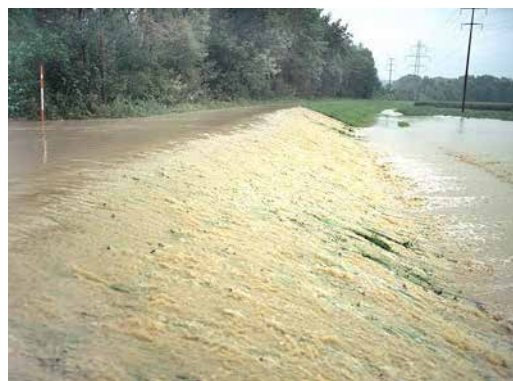
Abbildung 2.16: Hochwasserauswirkungen an der Reuss: überspülter Damm bei Jona, AG, August 2005 (Foto: B. Schelbert, Departement Bau, Verkehr und Umwelt, Kanton Aargau, Abteilung Landschaft und Gewässer).
